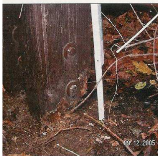
Abbildung 26 Stützenfuß mit Fäulnis infolge Erdkontakt (Bildnachw. Fn.: 33)
