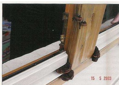
Abbildung 16, Folgeschaden von Hagelschaden am Fensterfries
