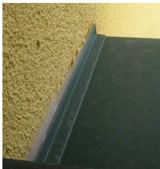
Abbildung 22, Fensterbankanschluss, zu schmale Fugenausbildung.
