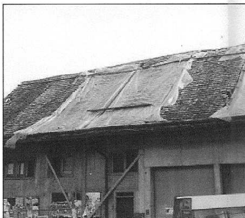
Foto 5.20 0.0 zerstört Bauwerk verlottert, unbrauchbar, eingesunken bis eingestürzt
