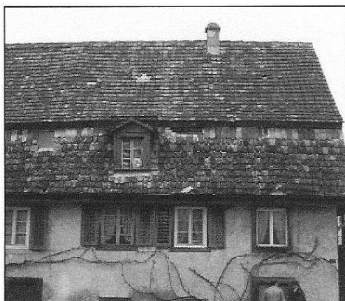
Foto 5.19 0.2 stark schadhaf Ziegel über weite Flächen abgewittert, grosse Anzahl gebrochen, Lattung und Holzabschlüsse angefault, Wasserdichtigkeit nicht mehr vorhanden, Unterdach überbeansprucht, Bauteil und damit Bauwerk nicht mehr gebrauchsfähig, unbewohnbar
